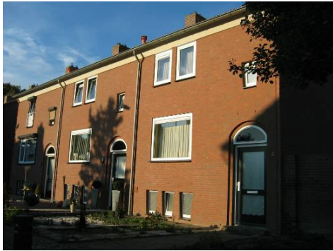
opgeknapte woningen in de Hazenkamp, waarvan de oorspronkelijke materialisering en detaillering is aangetast
